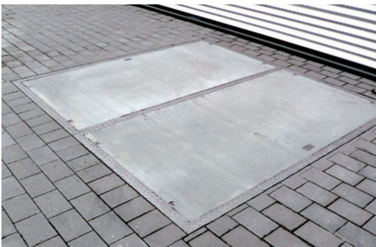
2-teilige Schachtabdeckung mit Betonoberfläche, Frankfurt
