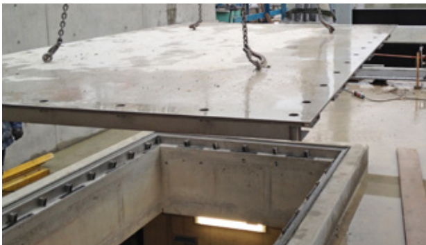
Überflutungssichere Abdeckung einer Montageöffnung, Donaukraftwerk bei Augsburg
