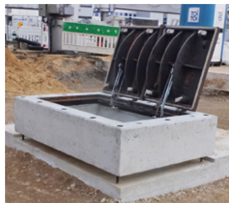
Kabelschachtabdeckung tagwasserdicht als Fertigteil mit höhenverstellbarem Stahlbetonrahmen, Düsseldorf
