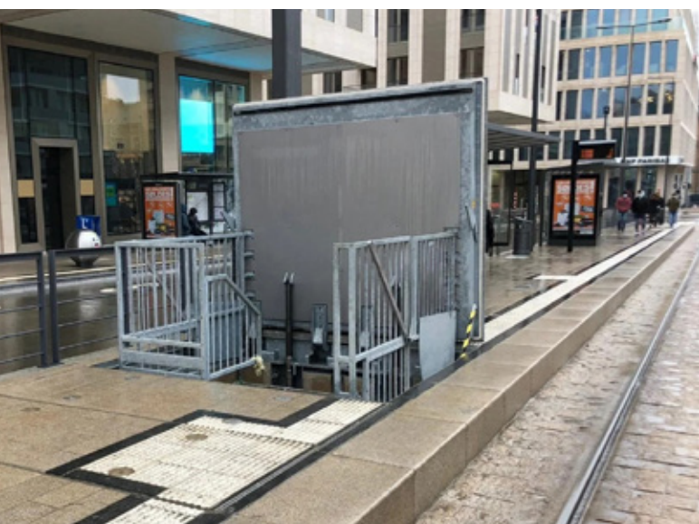
LKW-befahrbare, tagwasserdichte, hydraulische Trafoabdeckungen mit Wärmedämmung, Luxemburg
