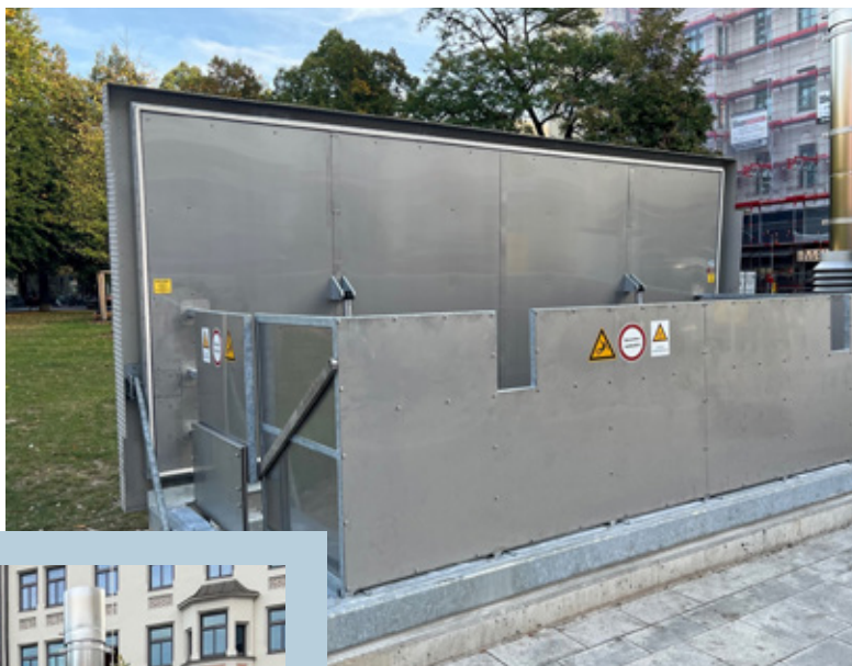
Hydraulisch betätigte Entrauchungsklappe mit Einfallenschutz am Isartor, München
