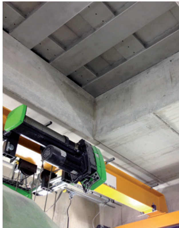
Überflutungssichere Abdeckung auf einer Montageöffnung, Ansicht von unten, Donaukraftwerk bei Augsburg
