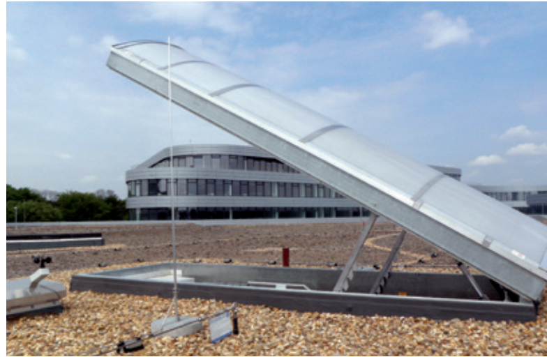
Hydraulisch betriebener Dachausgang und RWA-Klappe, Köln
