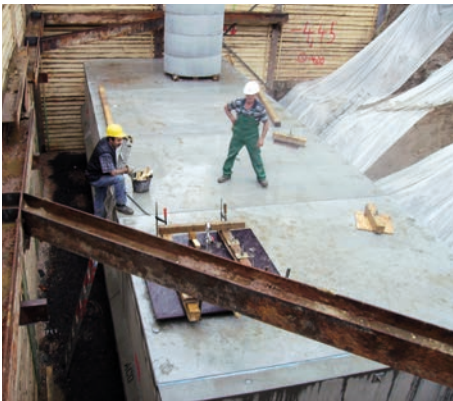
Einbaubeispiel: Löschwasserbehälter 100.000 l, Universität Mainz
